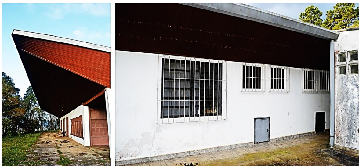
Fig. 7: Inclinação dos forros nas elevações norte e sul. Fonte: Heloísa Mônico dos Santos, 2016.
