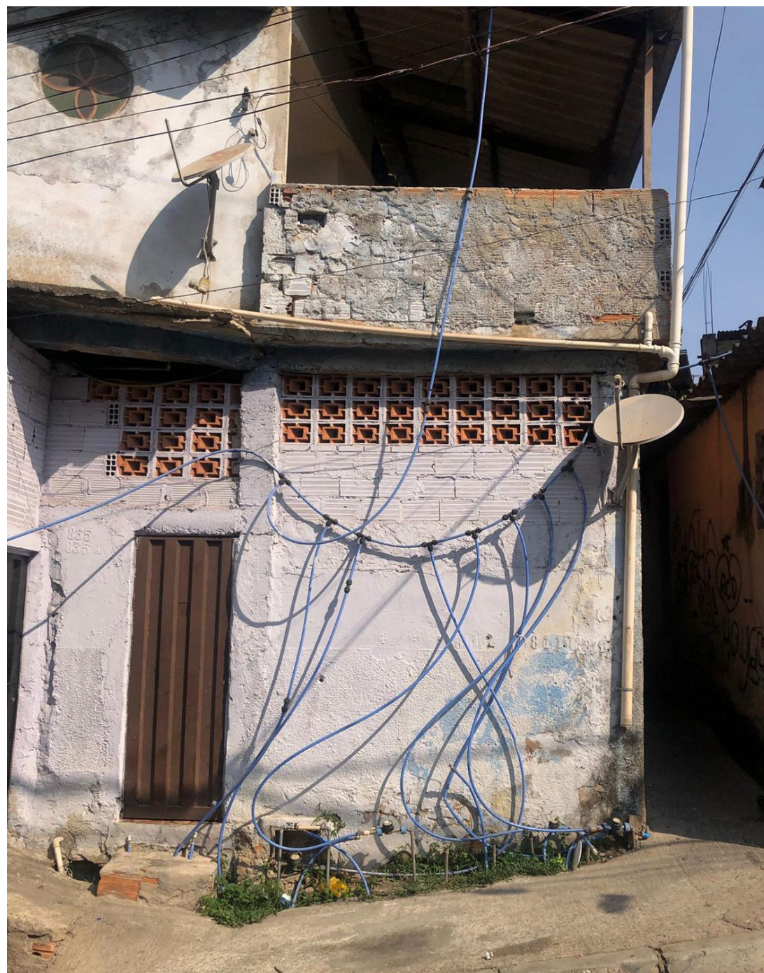
Fig. 3: Conexões de água expostas em fachada de casa na Pedreira Prado Lopes, em Belo Horizonte. Fonte: Autora, 2022.
