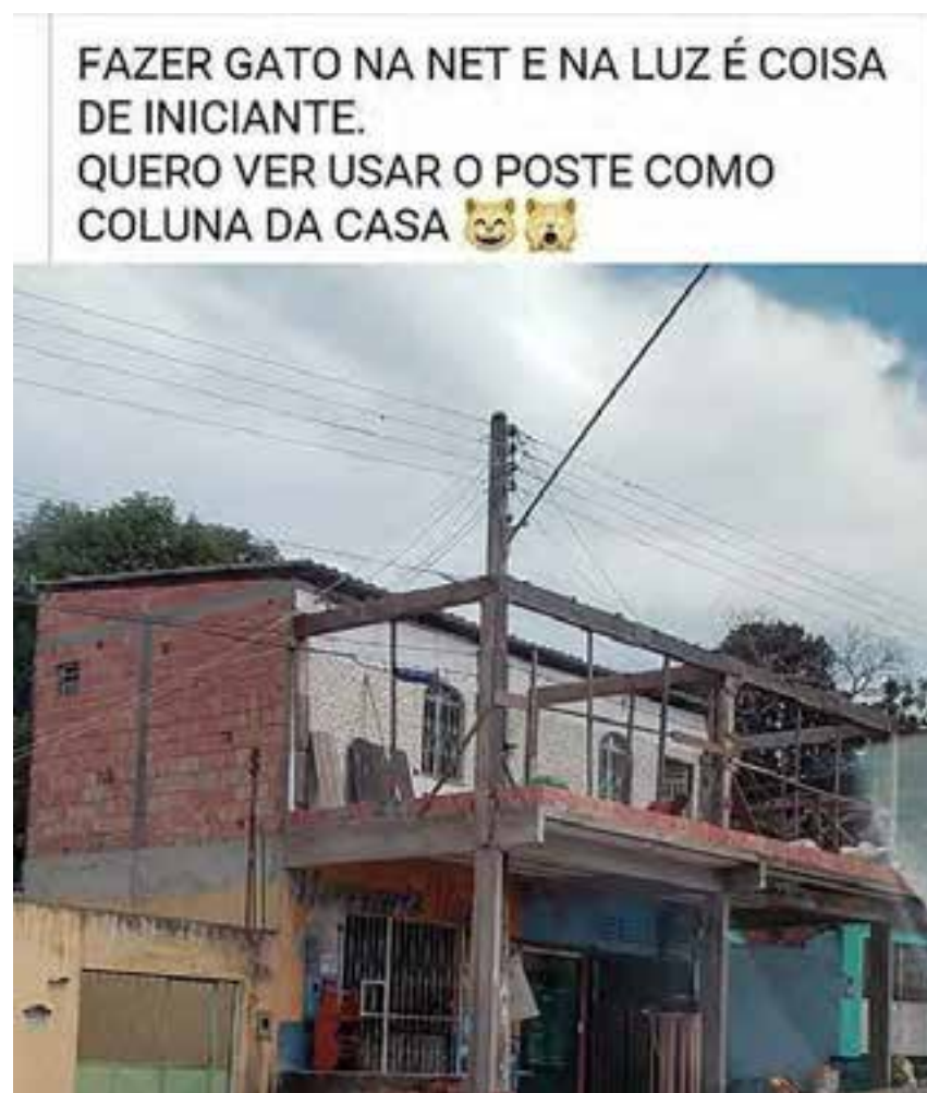
Fig. 1: Meme na internet sobre a forma improvisada de construir nas periferias urbanas, 2021. Fonte: iFunny, 2021. Disponível em: https://br.ifunny.co/picture/fazer-gato-na-net-e-na-luz-e-coisa-de-4ijidu759 . Acesso em: 09 ago. 2022.
